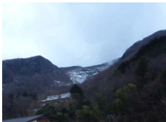
図2 早雲山駅駐車場からみられる 早雲山地すべり工事現場
